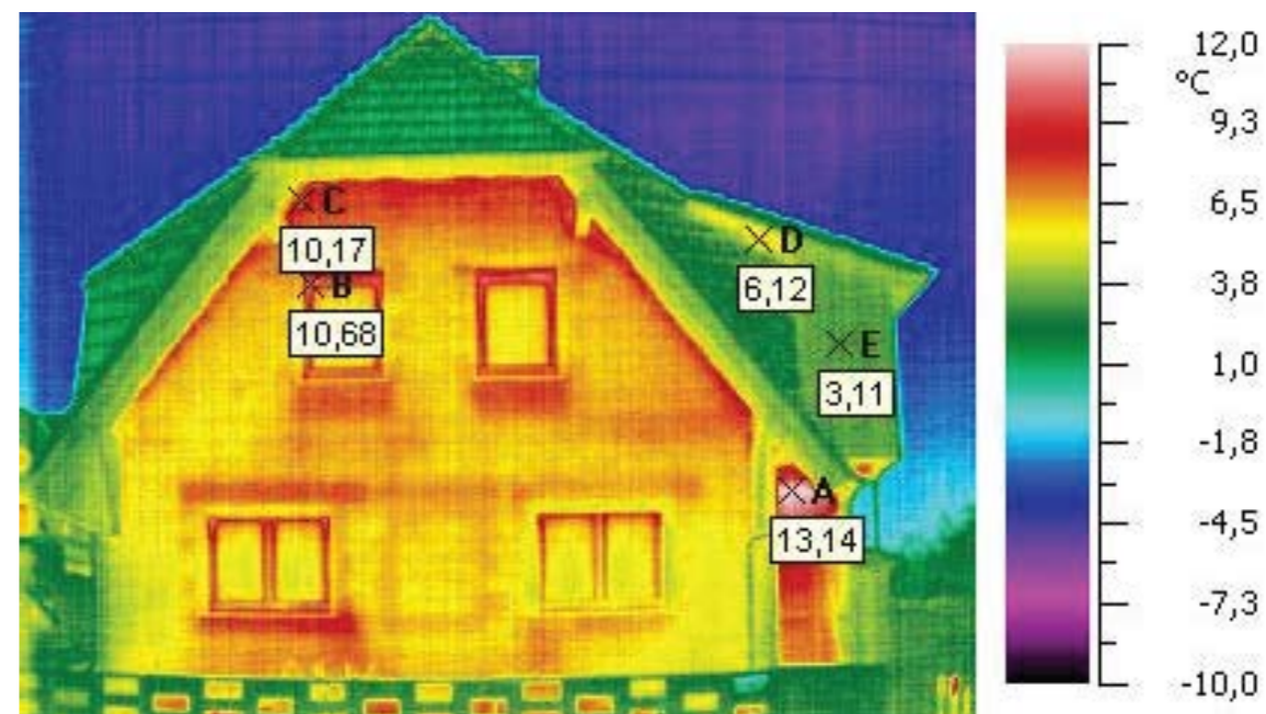
Wärmeverluste an einer Fassade Varmelekkasje fra en fassade
